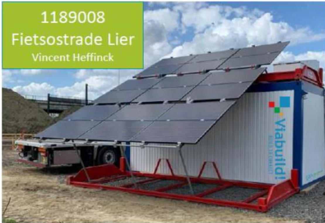
PV-installatie bij werfkeet
