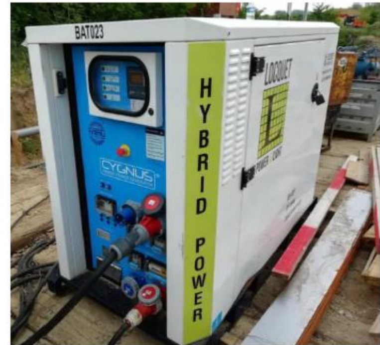
Battery pack ter vervanging van gewone dieselgroep
