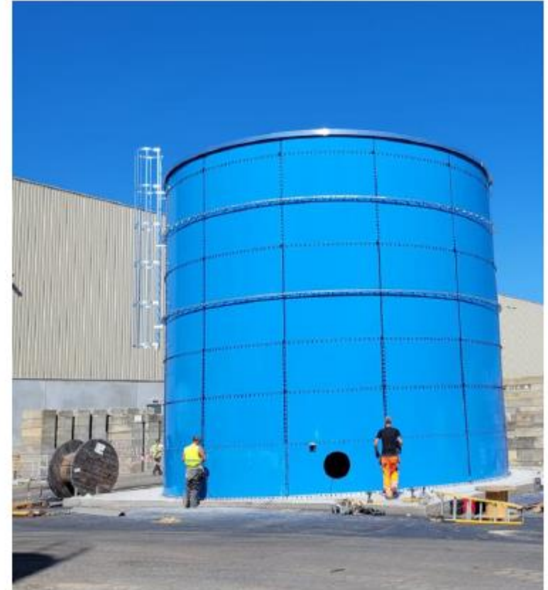
Opvang hemelwater op onze nieuwe betoncentrale (tank 655 m 3 )
